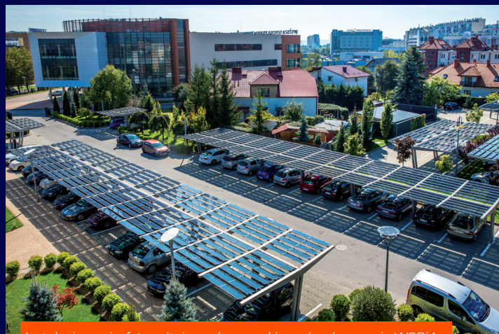
Instalacja ogniw fotowoltaicznych na parkingach w kampusie WSPiA.
